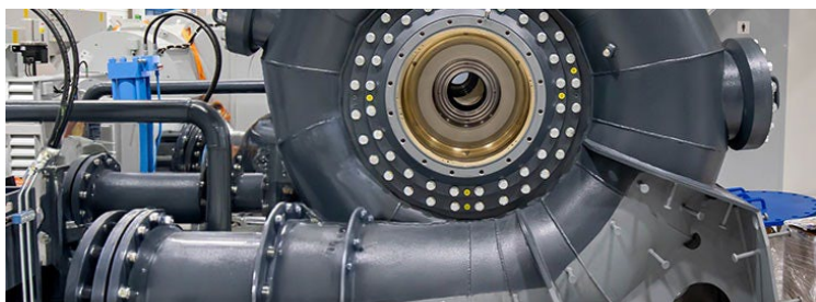
Monitoramento de vibração em turbinas hidrelétricas com o VibSys®.
