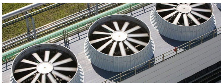
Monitoramento de vibração em maquinário BoP com VibSys® em usinas de geração de energia
